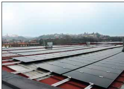
Солнечные батареи на крыше завода в Polpenazze. Площадь 13000 кв. м. Покрывают до 30% энергозатрат предприятия
